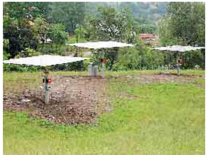
MORFASSO - I tre pannelli fotovoltaici del nuovo impianto
