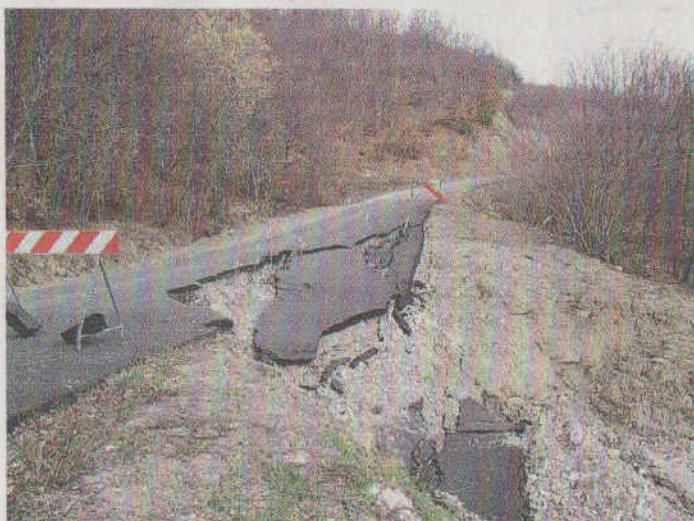
MORFASSO - La strada per Santa Franca interrotta all'altezza del bivio per Montelana
