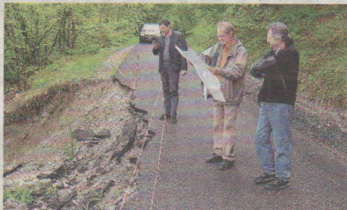
MORFASSO - Il sopralluogo alla frana. Da sinistra Allegri, Bernini e Rigolli (f. Saccomani)
