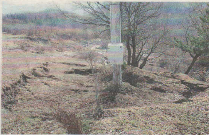
MORFASSO - Anche un traliccio dell'Enel minacciato dalla frana (foto Coduri)
