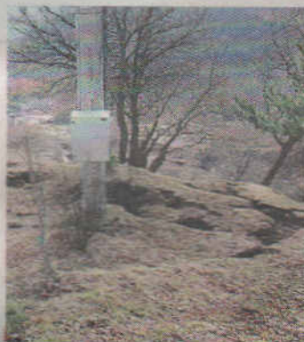
Il traliccio dell'alta tensione sulla frana
