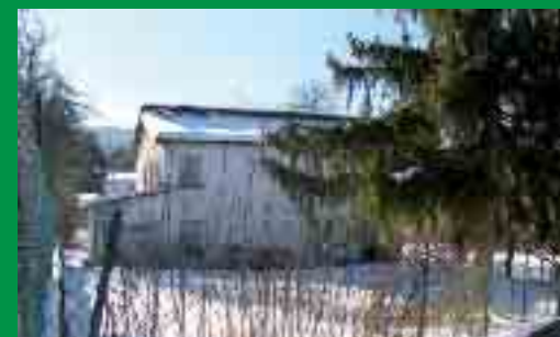
EX SCUOLA CASALI: vecchio edificio scolastico composto da n. 2 medie abitazioni più vani accessori da ristrutturare con annessa ampia area esterna di pertinenza
