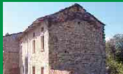
SELVA: Rustico in sasso interamente da ristrutturare, con area di pertinenza. Prezzo: € 25.000 trattabili
